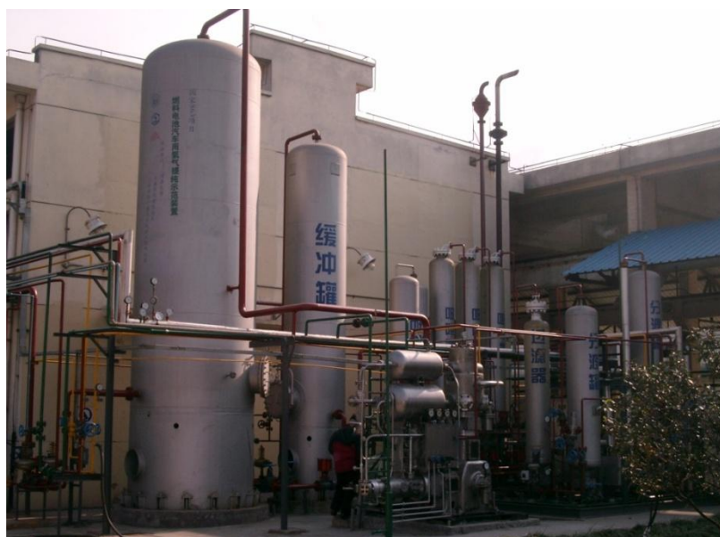
工业副产氢气提纯示范装置
