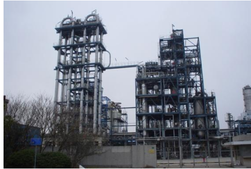
上海石化乙二醇装置
