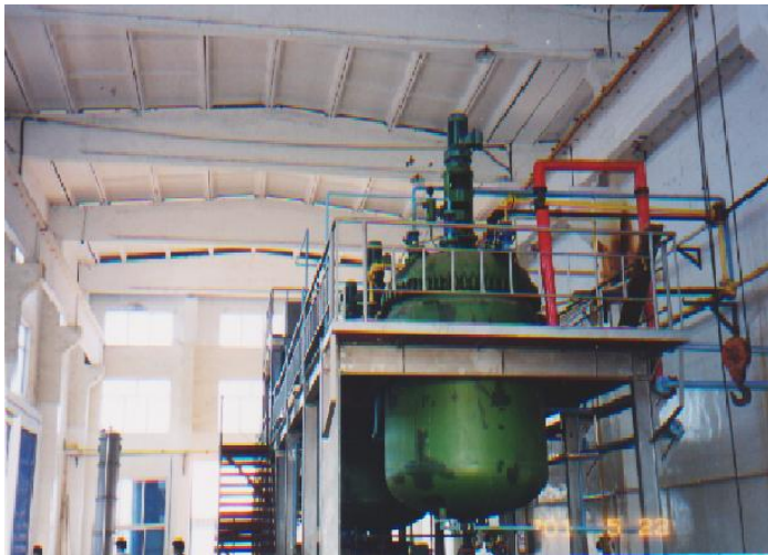
水处理药剂生产线
