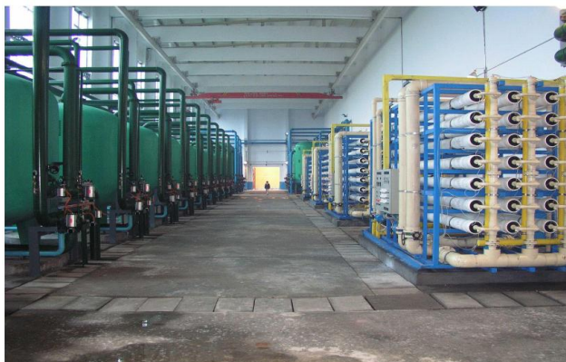
中铝公司中州分公司 4 \times 125 \text{ m}^3/\text{h} 反渗透除盐工程 上海同济水处理技术开发有限公司承建
